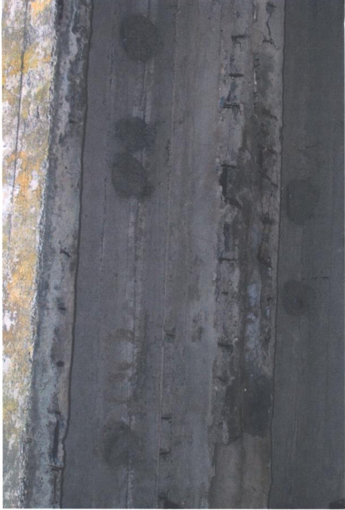
Фото №7 Оголение арматуры. Разрушение облицовки и защитного слоя бетона ребер крайних балок
