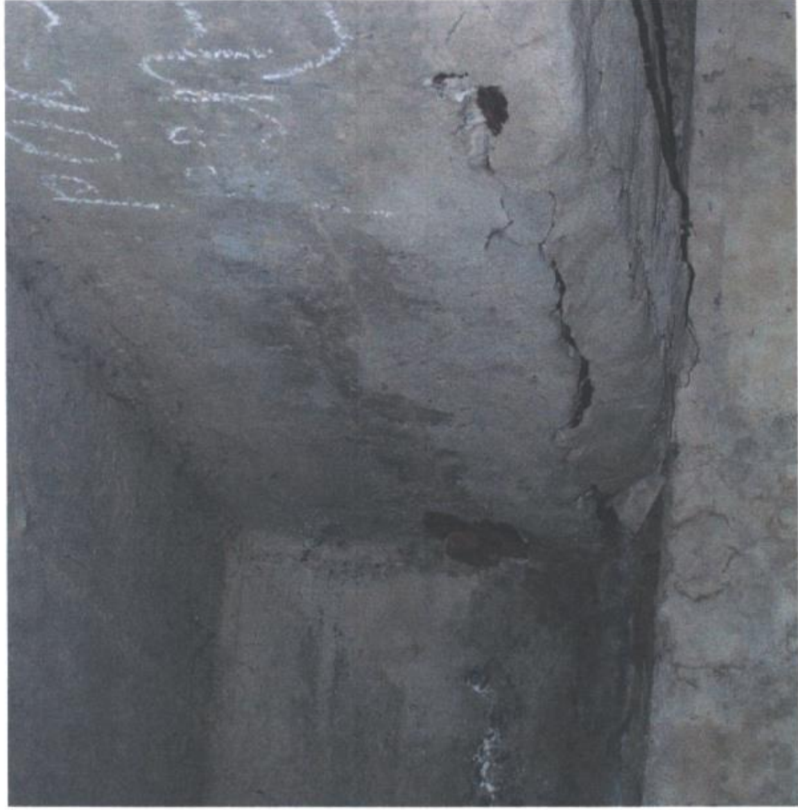
Фото №9 Разрушение бетона ребер балок №3 и №4 в месте опирания на насадку опоры №1.
