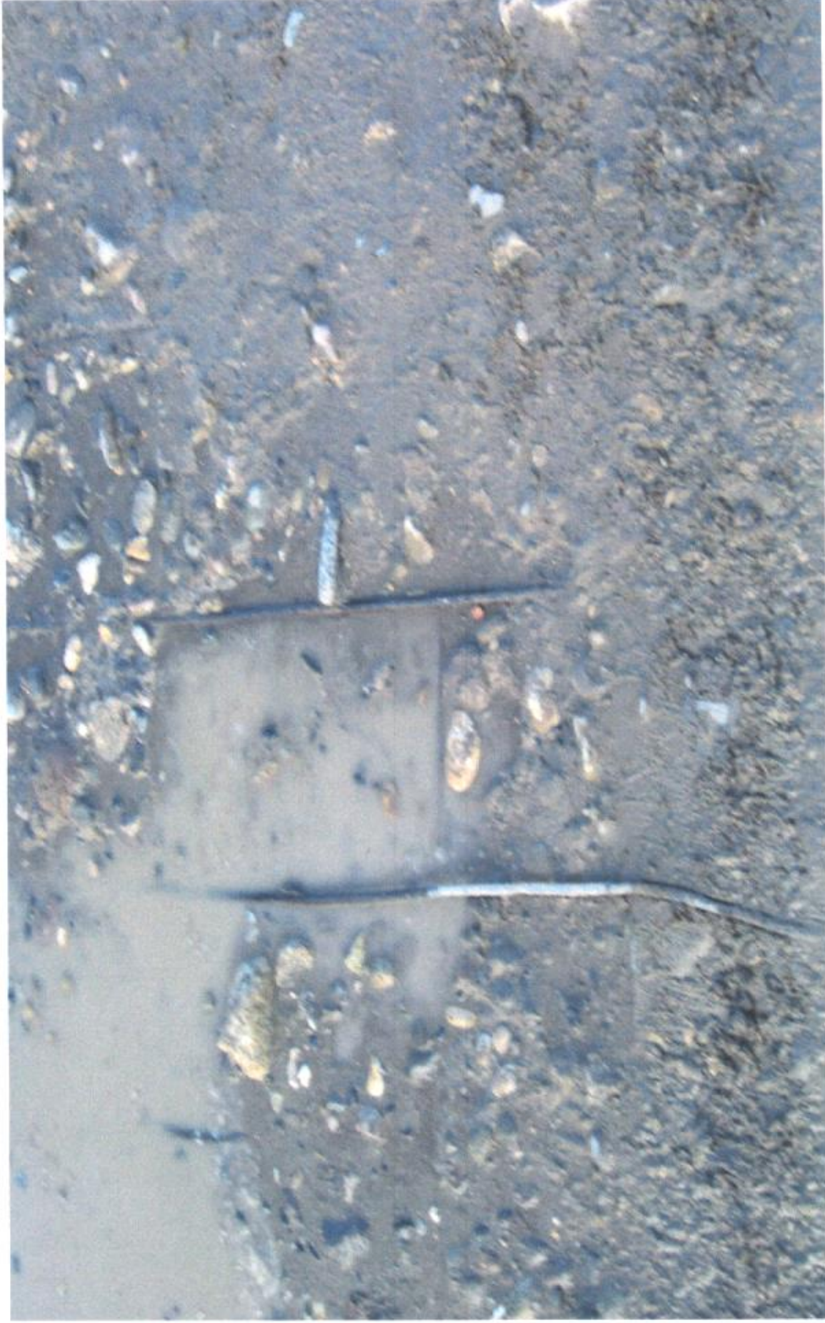
Фото №4 Проезжая часть. Разрушение, ш/б покрытия с оголением армосетки. Застой воды в выбоинах.
