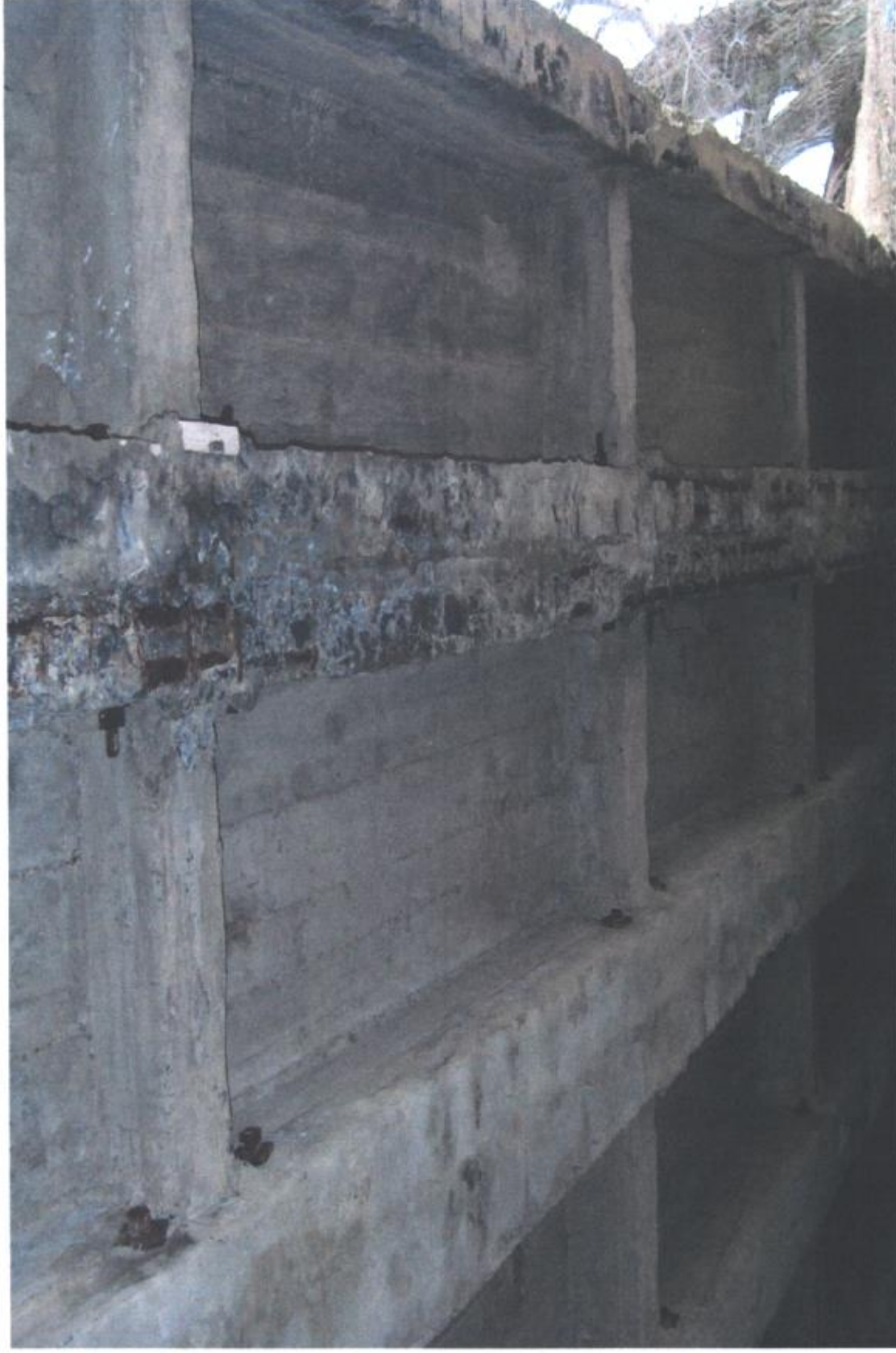
Фото №8 Оголение арматуры ребер крайних балок. Интенсивная коррозия арматуры и соединительных болтов. Раковины и мелкие трещины на защитном слое бетона диафрагм
